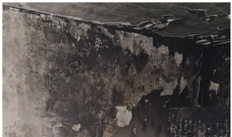
Wohnungsbrände verursachen in der Regel erhebliche Sachschäden und erfordern oft umfangreiche und langwierige Sanierungsarbeiten.
